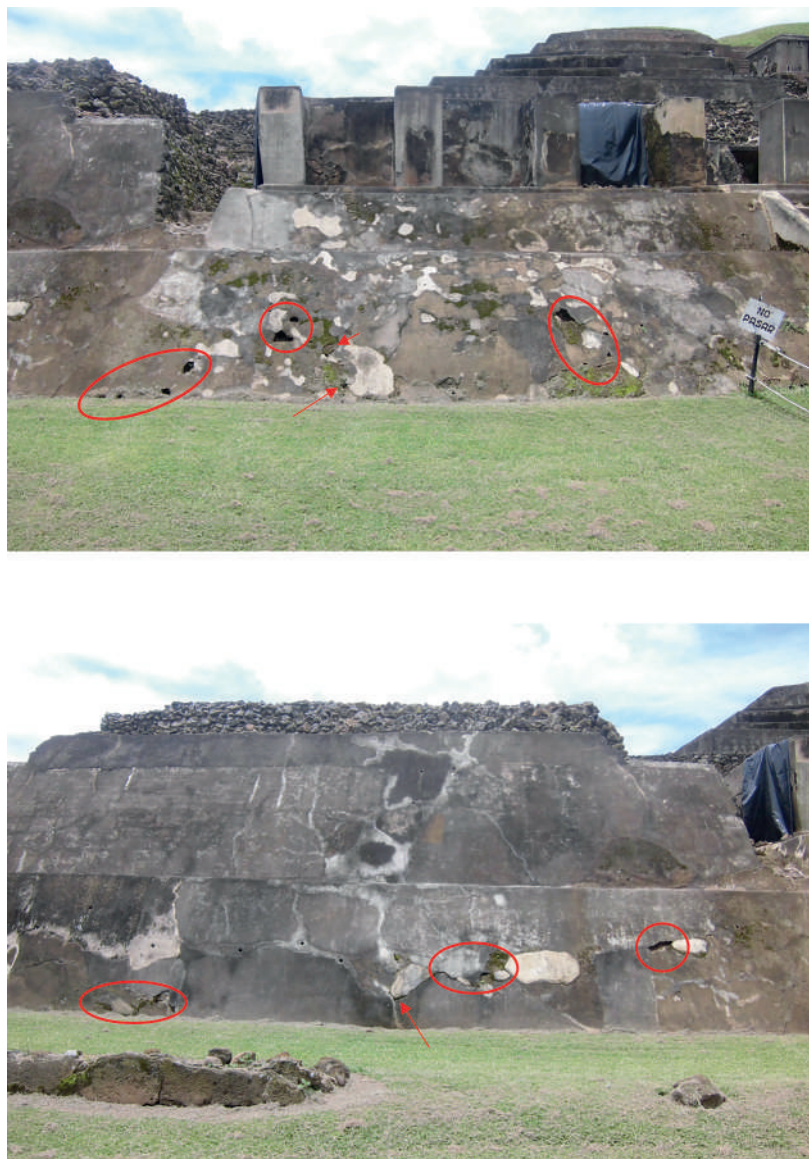
Figura 13. Lado oeste de la Gran Plataforma: (arriba) hoyos en el talud inferior; (abajo) fisuras registradas en las partes restauradas con cemento en las décadas de 1940 y 1950 (S. Shibata).
