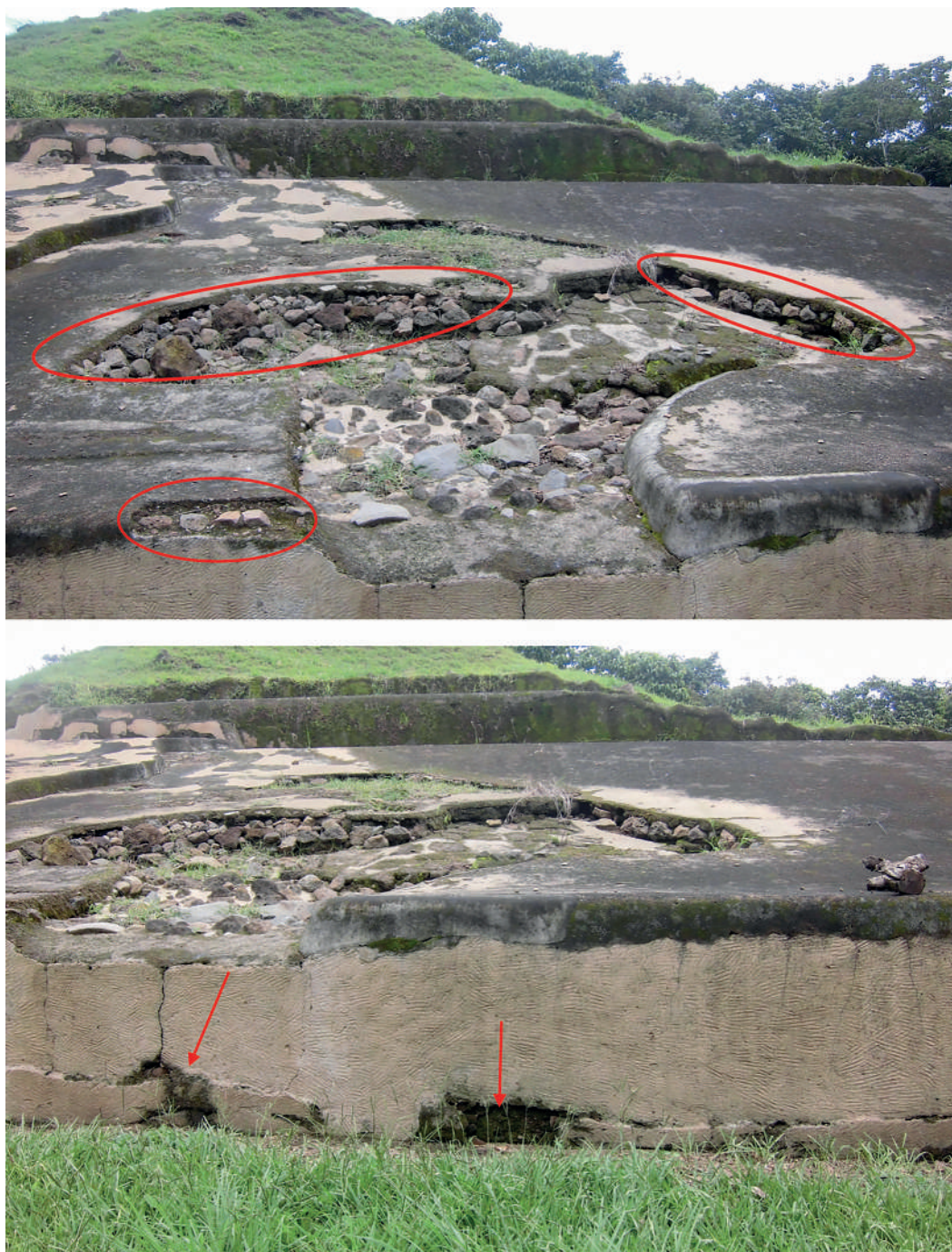
Figura 25. En el talud del lado norte del primer cuerpo, en donde se muestra el sistema constructivo, se registra el desprendimiento del repello aplicado entre 1997 y 1998 (S. Shibata).
