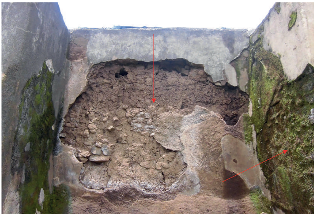
Figura 7. Deterioro del repello observado en la superficie de la pared oeste del cuarto norte ubicada entre la 3ª y 4ª columnas desde el lado oeste del edificio de las Columnas (B1-d1) y de la pared lateral norte de la 4ª columna (a la derecha) (S. Shibata).
