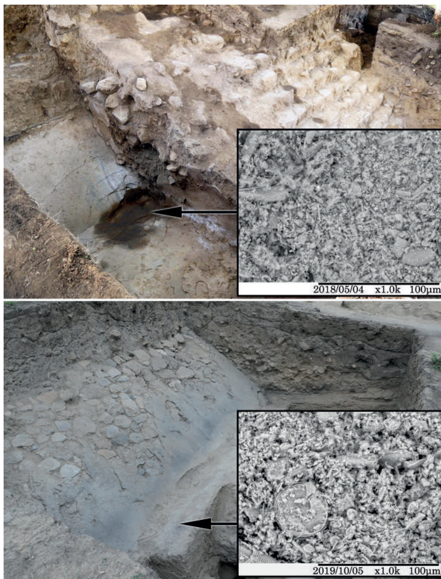
Figura 20. Argamasas de la pirámide Cerro Grande. Superior. Fachada oeste. Junto a esta imagen: micrografía del color blanco de la argamasas donde se identifican diatomeas a 1.0 k. Inferior. Fachada este. Junto a esta imagen: micrografía del piso de diatomeas a 1.0 k. Imágenes: ©PATP. (J. Cañetas/J. López).
