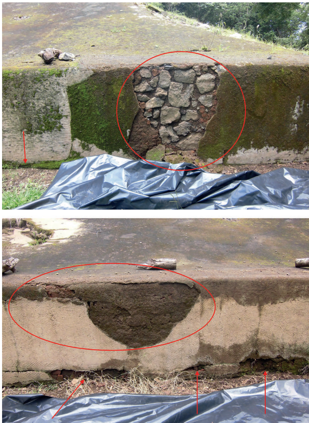
Figura 24. Esquina noreste del primer cuerpo donde se cayó totalmente el repello en dos puntos de la pared vertical (S. Shibata).
