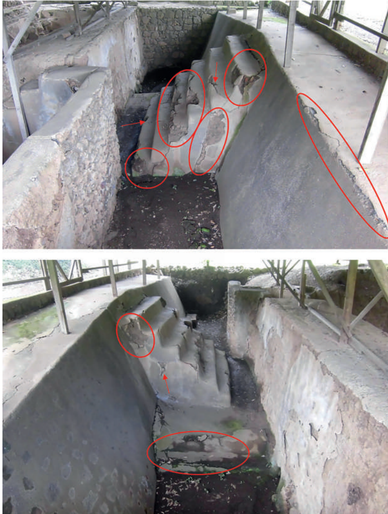
Figura 11. Dos vistas de los desprendimientos de repello restaurado y de las fisuras en las gradas de la Plataforma 3 (S. Shibata).
