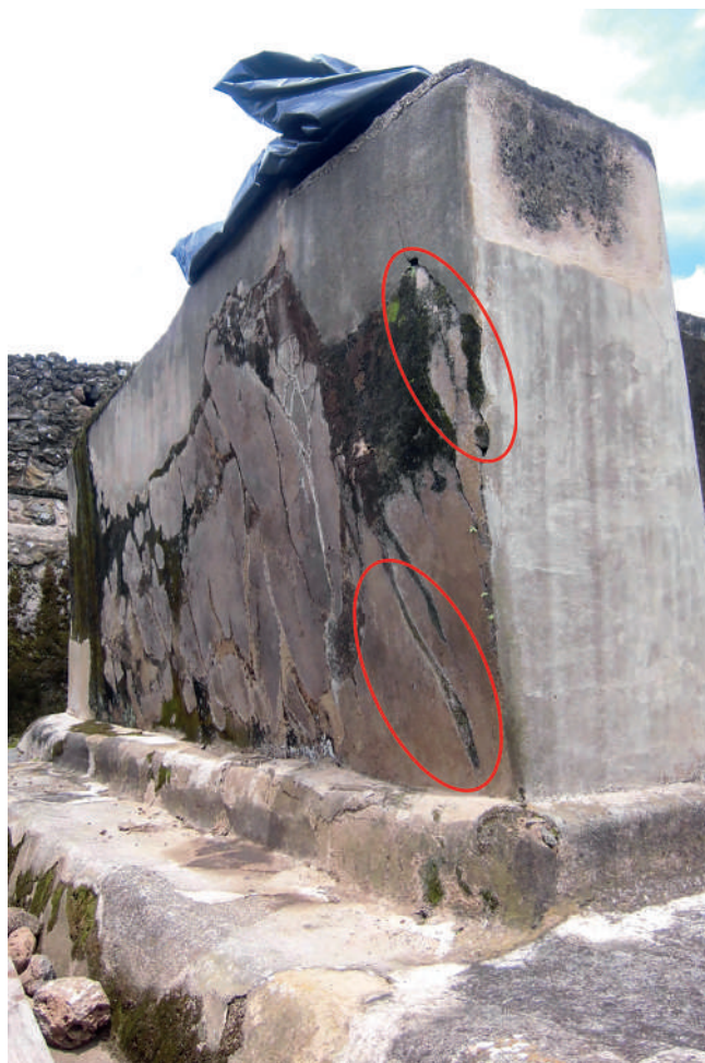
Figura 10. Fisura sobre la pared norte del cuarto norte (S. Shibata).
