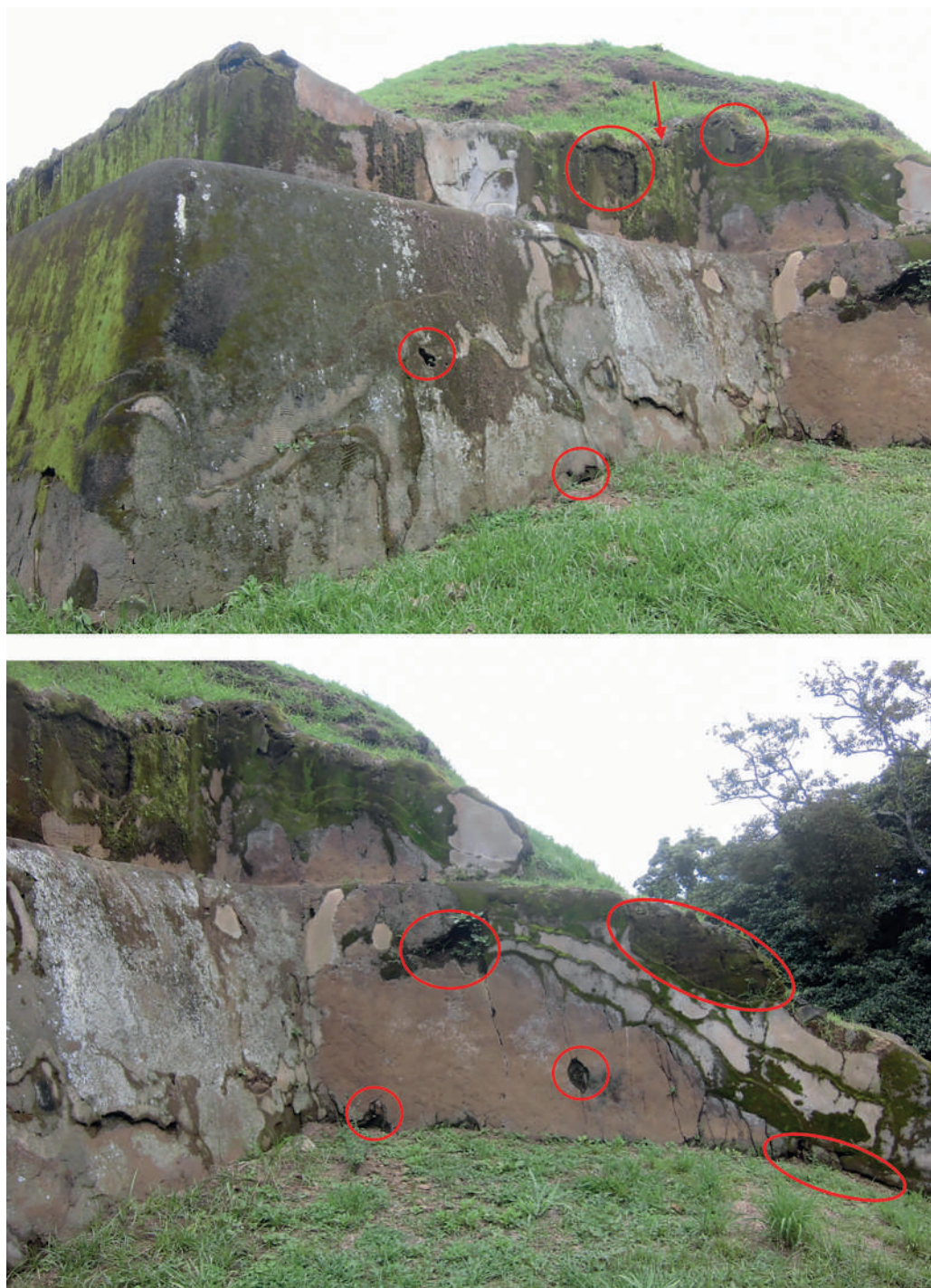
Figura 36. Sector noreste del segundo cuerpo de la estructura 5b: (arriba) 14 hoyos medianos y pequeños; (abajo) desprendimiento del repello aplicado entre 1998 y1999 en las paredes verticales reconstruidas y la franja de protección del talud del mismo sector (S. Shibata).
