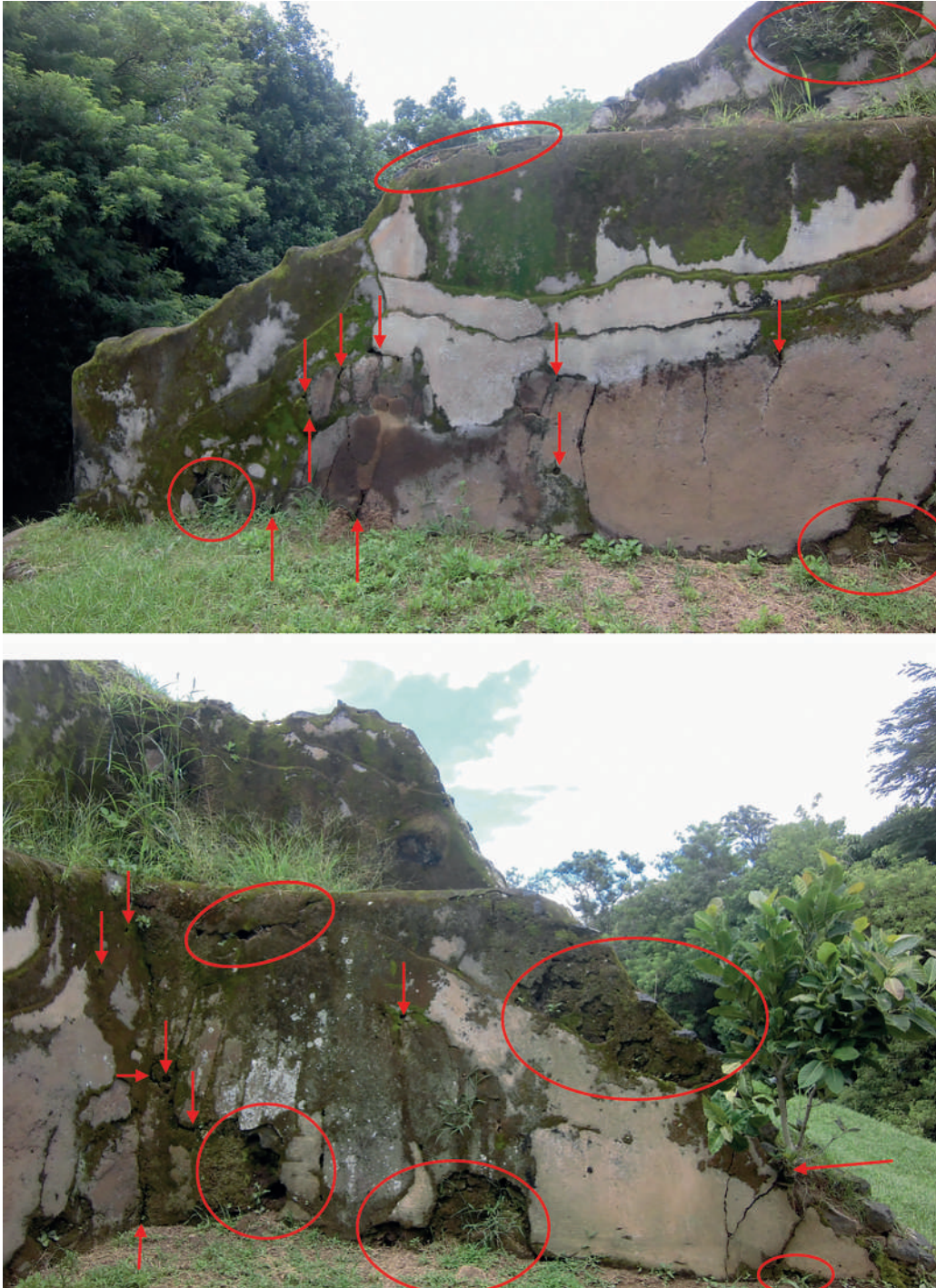
Figura 37. Sector noroeste del segundo cuerpo de la estructura 5b: (arriba) 13 hoyos medianos y pequeños; (abajo) desprendimiento de repello aplicado entre 1998 y 1999 y fisuras observadas en las paredes verticales reconstruidas y la franja de protección del talud del mismo sector (S. Shibata).
