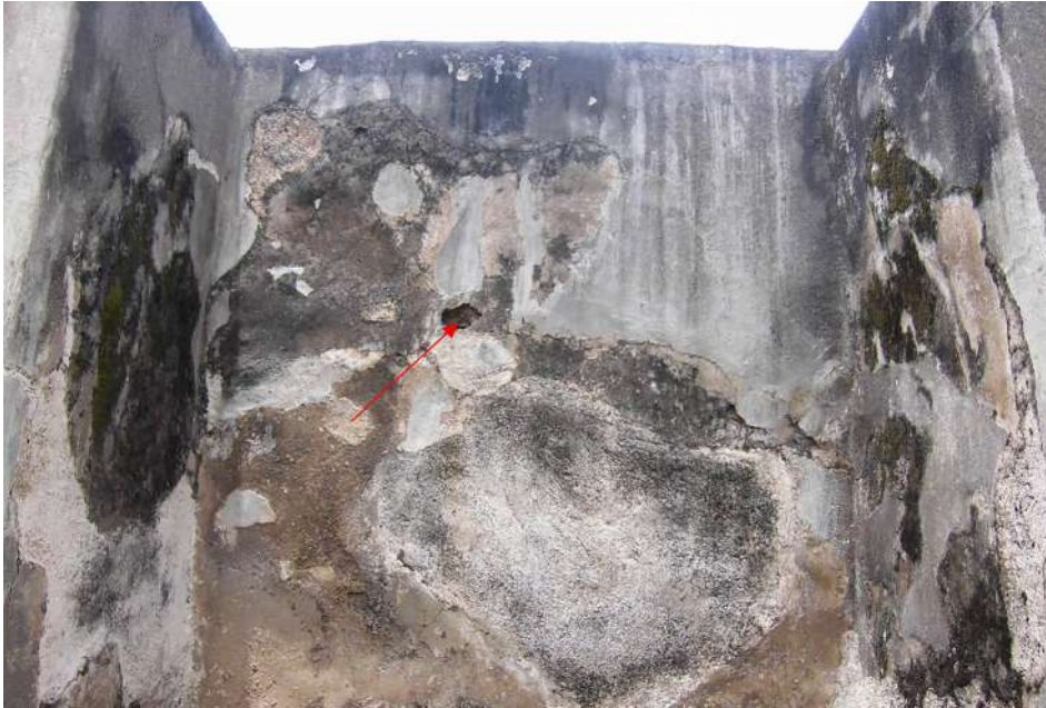
Figura 8. Puntos por intervenir sobre la pared externa del cuarto norte, ubicada entre la 2ª y 3ª columnas (S. Shibata).
