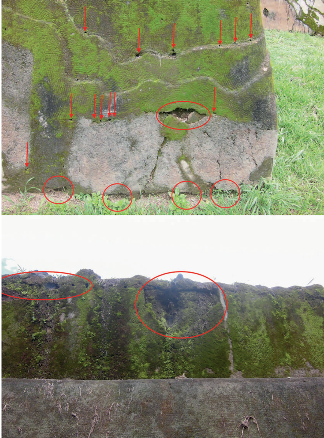
Figura 35. Segundo cuerpo de la fachada este de la estructura 5b: (arriba) hoyos diminutos causados por insectos; (abajo) desprendimiento del repello de reconstrucción (S. Shibata).
