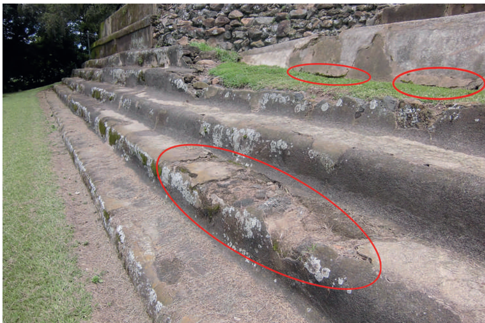
Figura 15. La pérdida de repello se observa en la escalinata amplia, especialmente en la parte inferior de la primera grada y sobre las gradas (S. Shibata).
