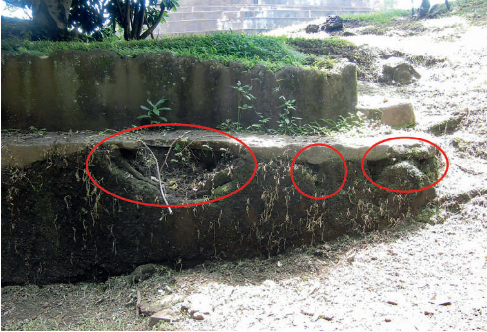
Figura 19. Repello desprendido de la pared, perteneciente al estilo arquitectónico del Clásico tardío (S. Shibata).
