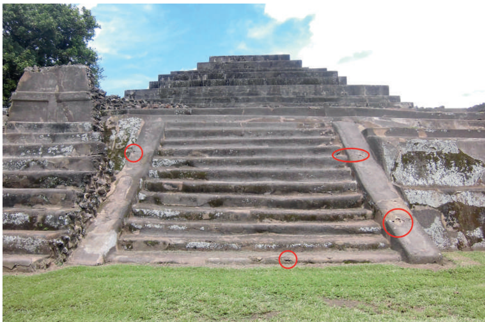
Figura 14. Escalinata norte y estructuras de diferentes etapas constructivas. En la escalinata con alfardas hay hoyos pequeños y fisuras (S. Shibata).
