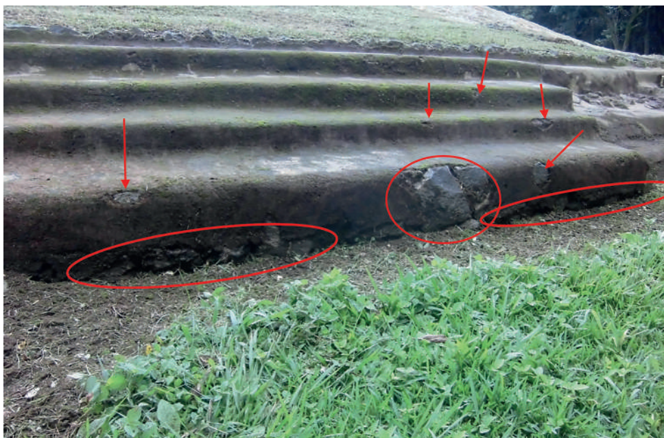
Figura 30. En las gradas del primer cuerpo de la Estructura 5b se observa un desprendimiento pequeño del repello aplicado en 2006 y 2007 (S. Shibata).
