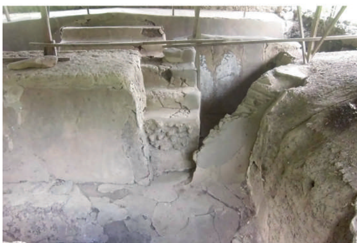
Figura 12. Desprendimientos de repello restaurado y fisuras en las Plataformas 2a y 2b (S. Shibata).
