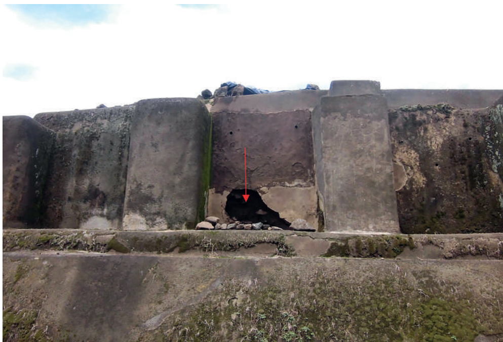
Figura 6. Cavidad que se observa entre la 2ª y 3ª columnas del cuarto sur del Edificio de las Columnas (B1-d1) (S. Shibata).
