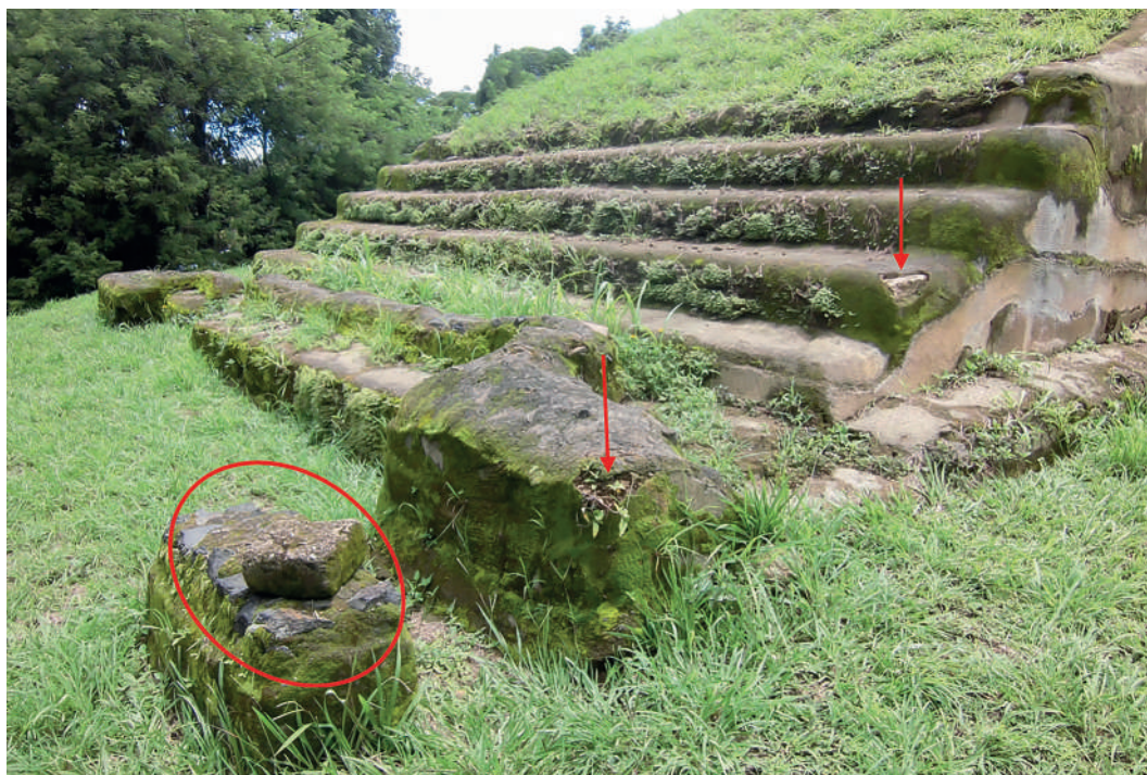
Figura 34. En las gradas del segundo cuerpo de la Estructura 5a y 5b se registra el desprendimiento del repello aplicado en 2006 y 2007 (S. Shibata).
