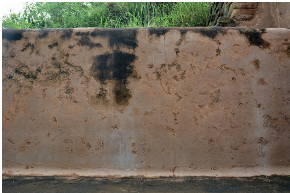
Figura 19. Grieta en la superficie del repello de argamasa del segundo cuerpo, registrada el 13 de junio de 2018 (A. Ichikawa).
