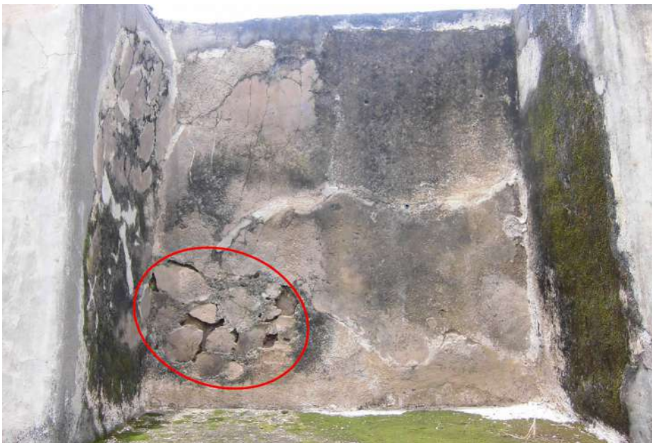
Figura 9. Hoyos pequeños sobre la pared externa del cuarto norte, ubicada entre la 1ª y 2ª columnas (S. Shibata).
